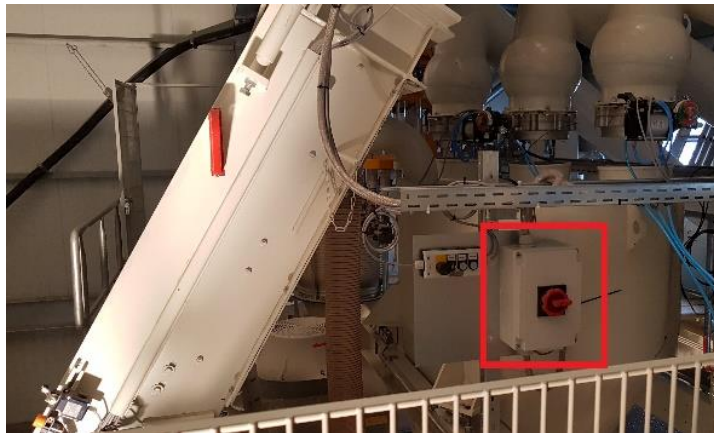
Reparaturschalter in der Anlagenperipherie
