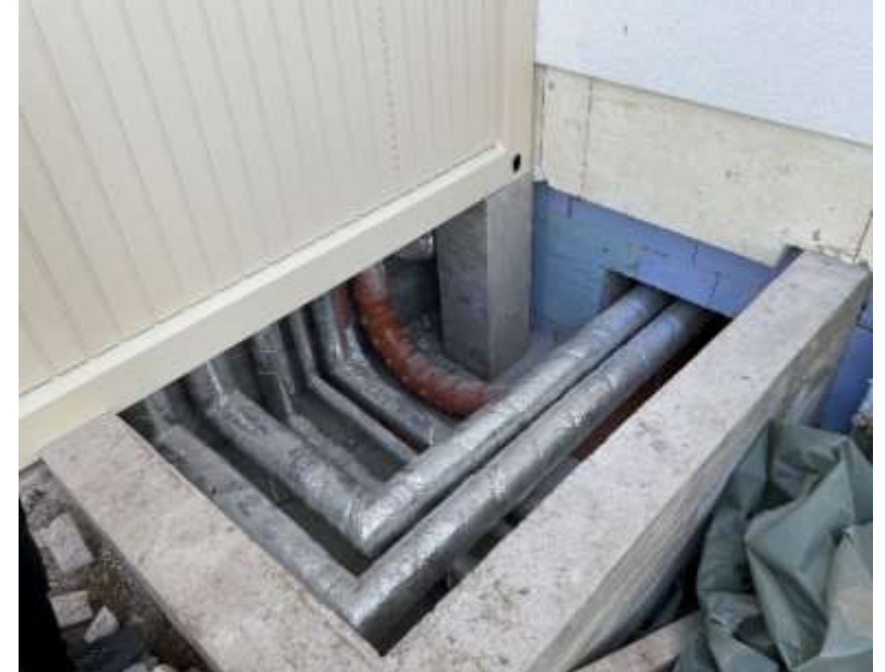
Beispiel eines Anschlusskanals zwischen Energiemodul und Gebäude
